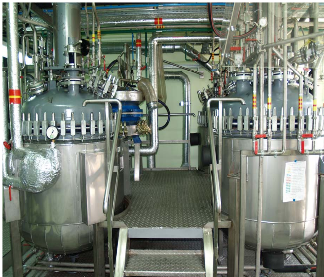
2008. gadā veikta rekonstrukcija. Novecojušās iekārtas nomainītas pret slēgtām, ērti apkalpojamām iekārtām.
