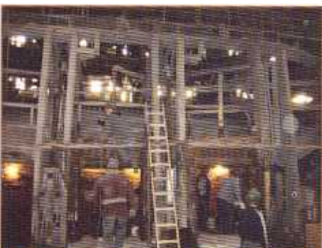
3. attēls. Augsts nelaimes gadījumu risks remontdarbu laikā – nav nodrošinātas piemērotas sastatnes, kas nodrošina drošu darbu veikšanu augstumā.
