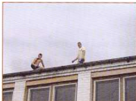
2. attēls. Augsts nelaimes gadījumu risks būvniecībā – nav uzstādītas aizsargmargas, kā arī nodarbinātie nav nodrošināti ar piemērotiem individuālās aizsardzības līdzekļiem (pretkritienu aizsardzībai, aizsargķiverēm u.c.).
