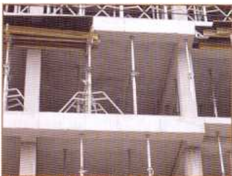
1. attēls. Augsts nelaimes gadījumu risks būvniecībā – objektā nav uzstādītas aizsargmargas nodarbināto aizsardzībai kritieniem no augstuma.
