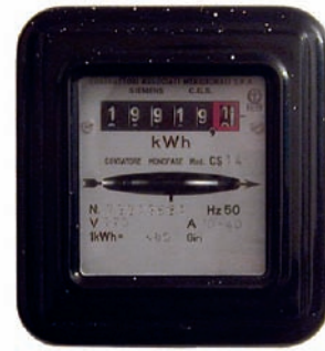
4. attēls. Elektrības skaitītājs
