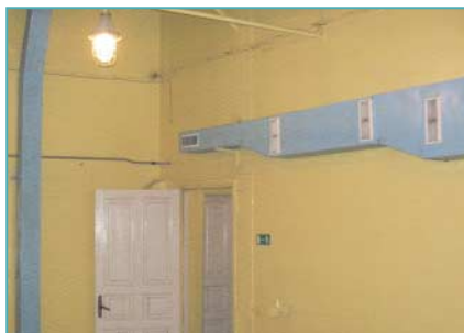
4. attēls. Ventilācijas sistēma sprādzienbīstamā telpā.
